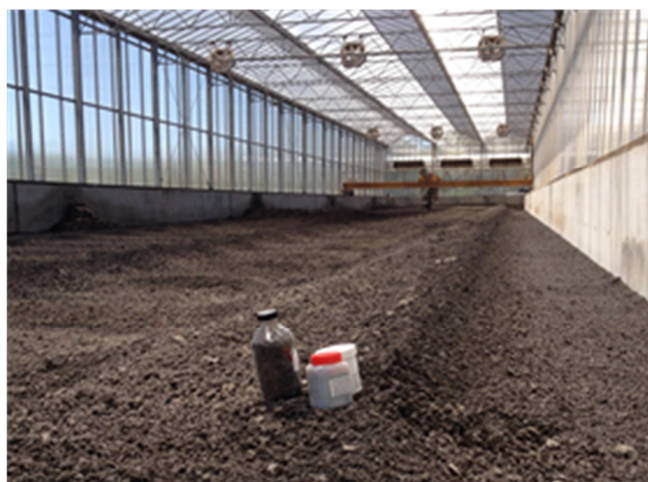
Séchage solaire des boues de la station d'épuration de Saint-Benoît
